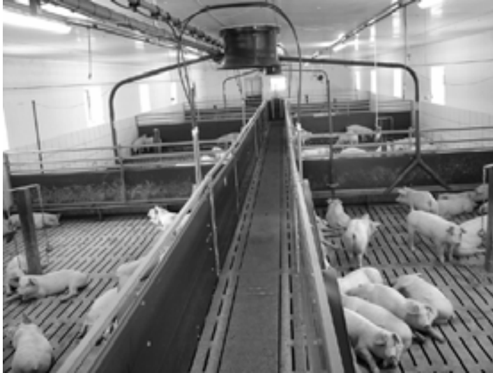
Abb. 1: Versuchsabteil mit Hochdruck-Vernebelungsanlage zur Kühlung (Wasserleitungen mit Hochdruckdüsen zur Vernebelung sind seitlich über den Fenstern montiert)
